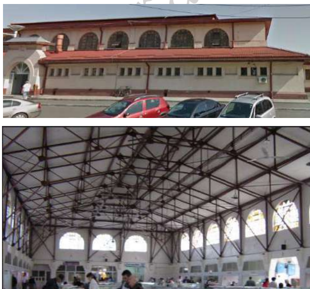
Figura 7.16 Clădire cu structura în cadre contravântuite din oțel amplasată în Brăila (Piața Halelor – vedere din exterior și vedere din interior )
